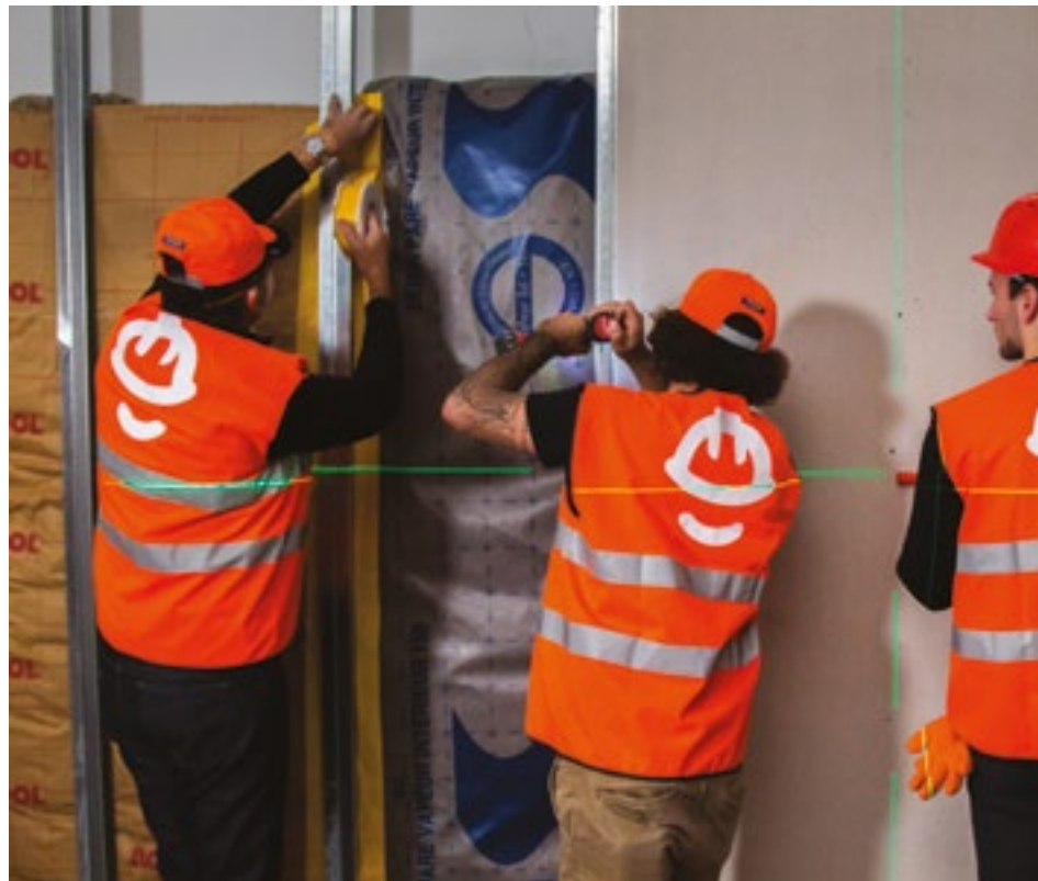
↑ Élèves en train de poser une isolation thermique (laine isolante, couche pare-vapeur et placo).
