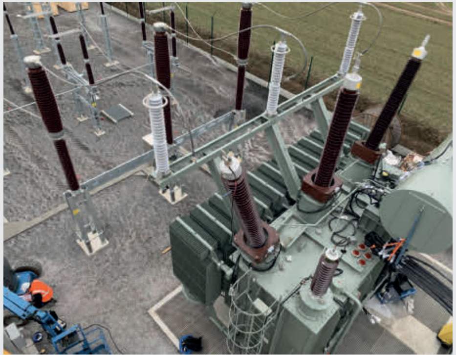
Transformateur 225kV d'un parc éolien.
