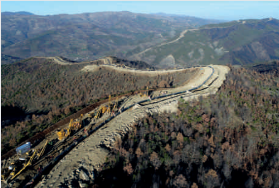
À son achèvement, le projet Trans Adriatic Pipeline aura vu la pose totale de 400 km de pipelines par SPIECAPAG en Grèce et en Albanie.
