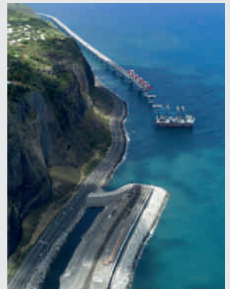
Nouvelle Route du Littoral - La Réunion - Viaduc en mer d'une longueur de 5,4 kms le long du littoral. Le Chantier reliera d'ici 2020 les deux communes de Saint-Denis et de la Possession.
