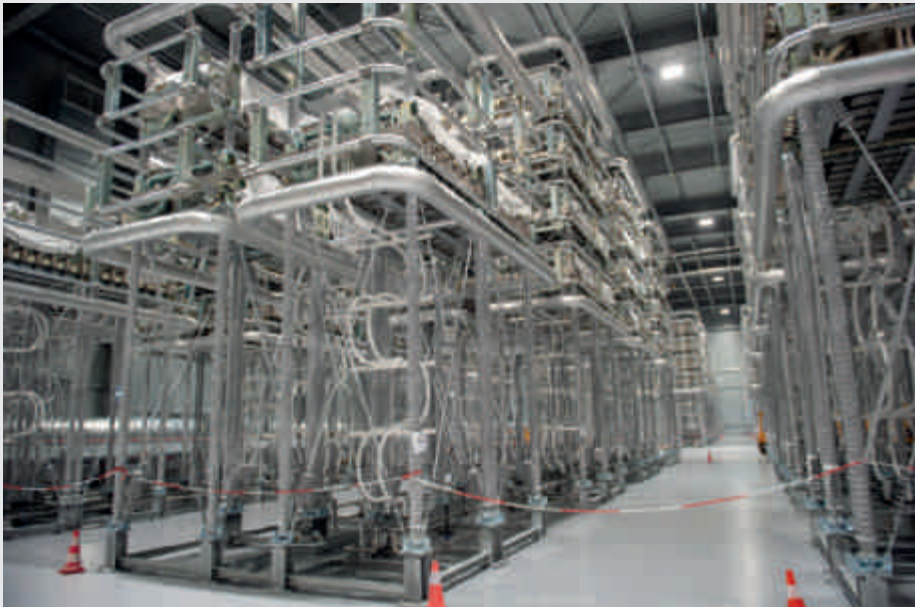
Hall de conversion du courant électrique de Coquelles.
