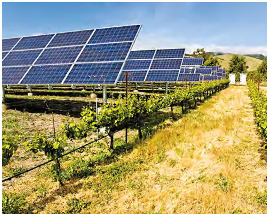
Des panneaux photovoltaïques au-dessus des vignes.
