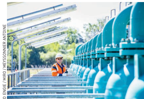
Inspection des manifolds sur le site de stockage souterrain de gaz naturel Storengy de Chémery.
