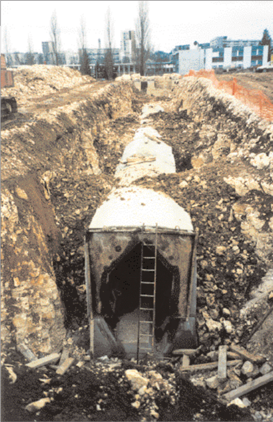
Galerie en cours de construction dans une extension du quartier de Planoise à Besançon. Notez la forme ovoïde de l'habitacle qui réduit les armatures à quelques coutures entre radier et toit.
