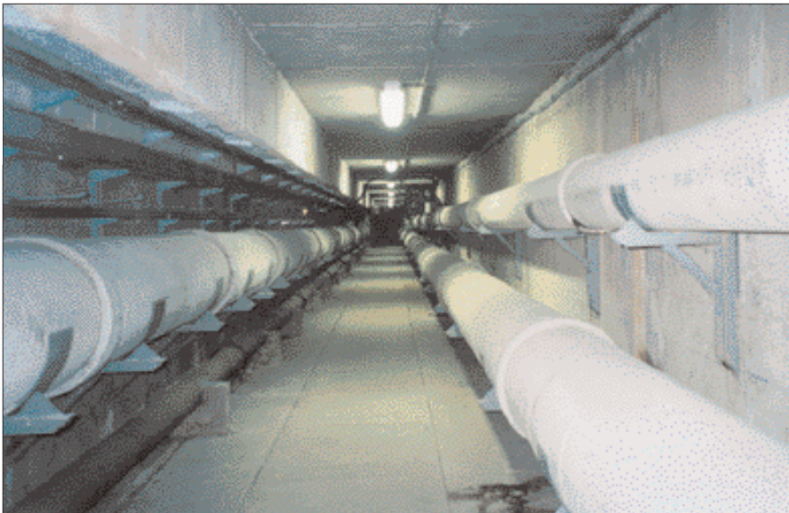
Galerie du Colombier (quartier neuf mais central) à Rennes. La galerie est dite "sèche" (pas d'écoulement libre de l'eau pluviale).
